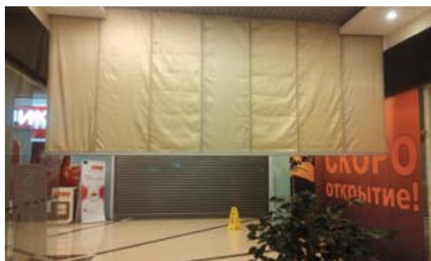
Рис. 28. Дымозащитные шторы в холле ТРЦ
