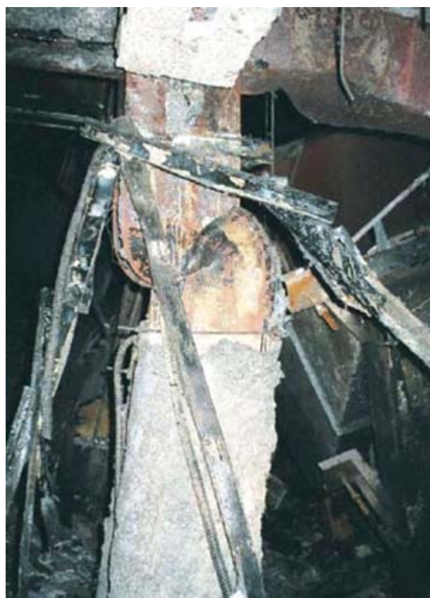
Рис. 7. Характерная картина особенностей деформации стальных балок и колонн и повреждения огнезащиты этих конструкций в результате воздействия пожара в здании ВТЦ-5 во время событий 11 сентября 2001 г. [1]
