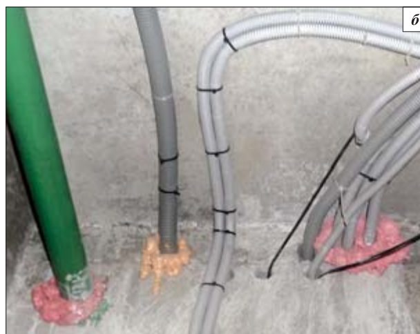
Заделка отверстий в противопожарной преграде в месте прохождения пучка кабельных изделий (а) и трубопроводов (б) огнестойкой монтажной пеной (выполненная с нарушением требований пожарной безопасности)
