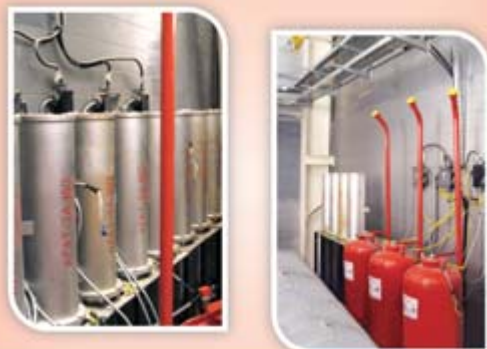
Установки аэрозольно-порошкового пожаротушения
