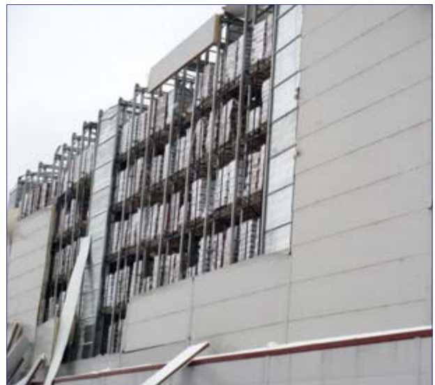
Рис. 6. Последствия локального аварийного взрыва в складском помещении
