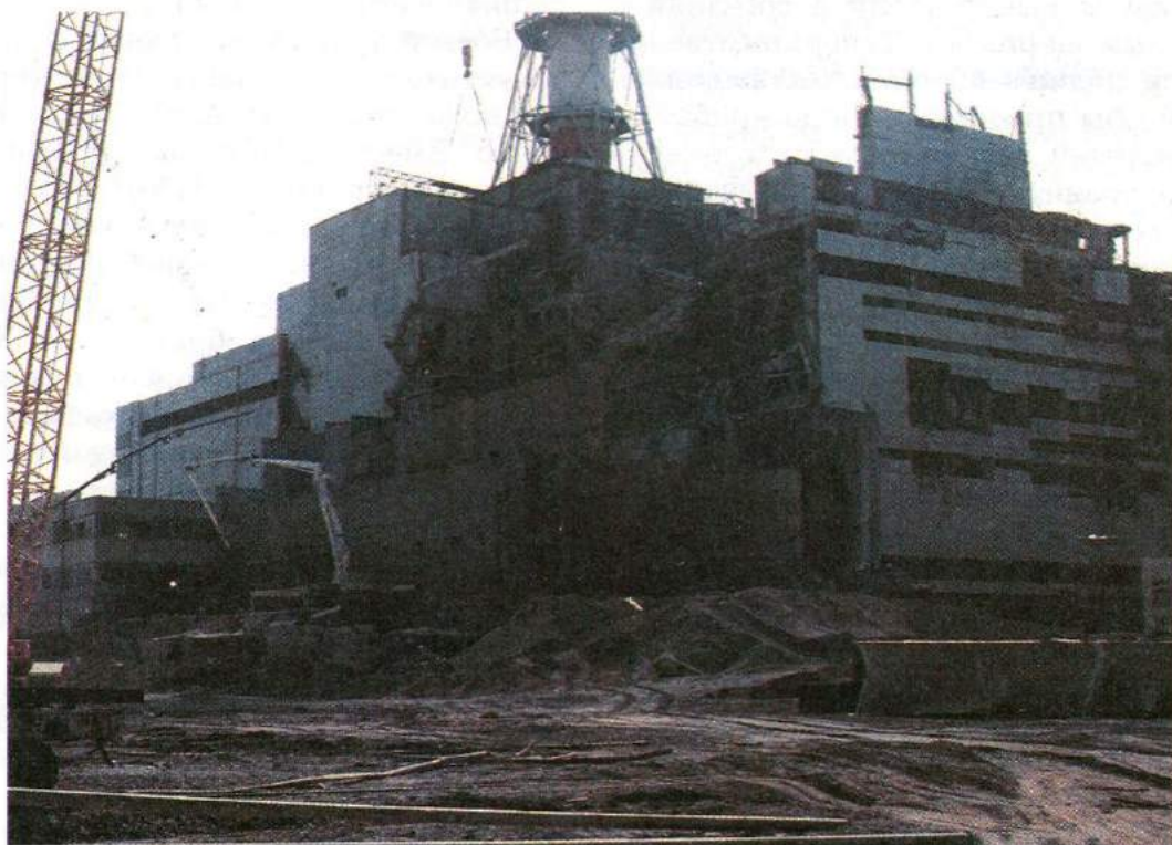
Разрушенный блок Чернобыльской АЭС.
