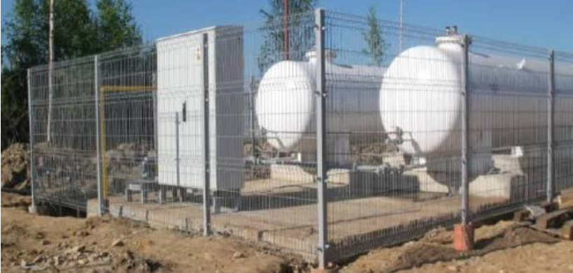
Рис. 1.10. Общий вид системы автономного энергоснабжения СУГ из двух резервуаров геометрическим объемом 12 \text{ м}^3 каждый
