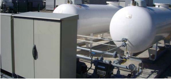
Рис. 1.11. Общий вид системы автономного энергоснабжения СУГ из двух резервуаров геометрическим объемом 12 \text{ м}^3 каждый
