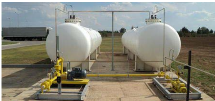
Рис. 1.9. Общий вид системы автономного энергоснабжения СУГ из двух резервуаров геометрическим объемом 20 \text{ м}^3 каждый
