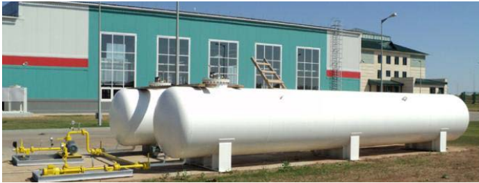
Рис. 1.12. Общий вид системы автономного энергоснабжения СУГ из двух резервуаров геометрическим объемом 20 \text{ м}^3 каждый
