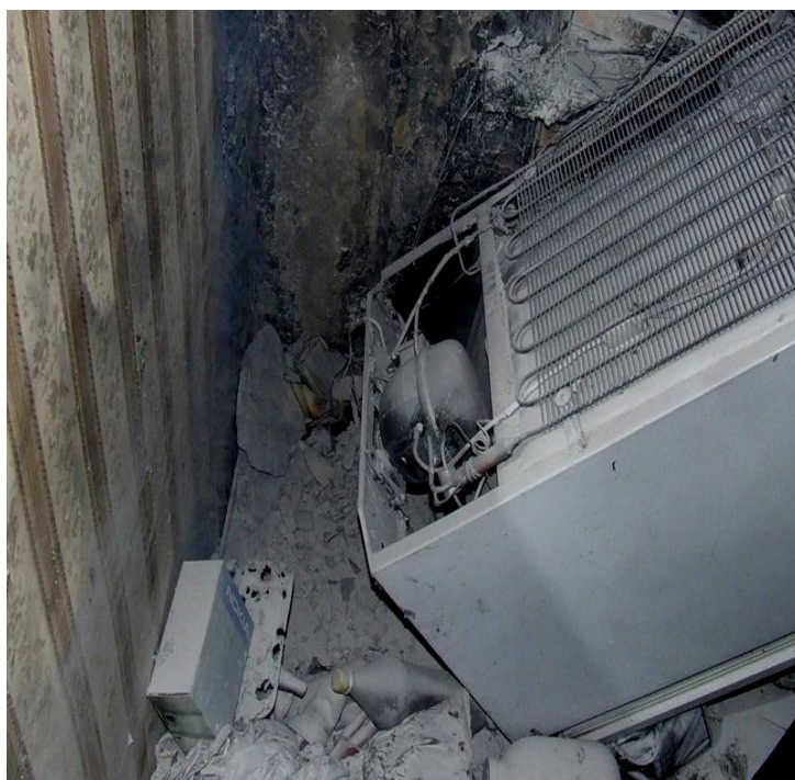
Рисунок 13. Следы аварийной работы холодильника
