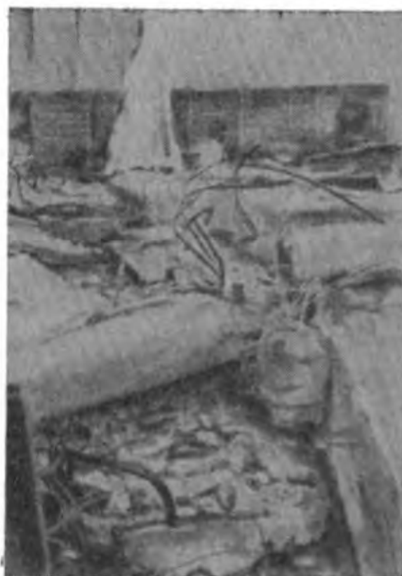
РИС. 3.2. ОБЩИЙ ВИД КОНСТРУКЦИИ ИЗ ПРЕДВАРИТЕЛЬНО НАПРЯЖЕННОГО ЖЕЛЕЗОБЕТОНА ПОСЛЕ ПОЖАРА
