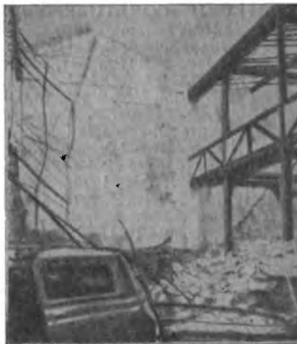
РИС. 6.2. ОБЩИЙ ВИД КНИЖНОГО СКЛАДА ПОСЛЕ ПОЖАРА. СКЛАД БЫЛ ПЕРЕКРЫТ ЧАСТИЧНО ДЕРЕВЯННОЙ, ЧАСТИЧНО СТАЛЬНОЙ КОНСТРУКЦИЕЙ. ДЕРЕВЯННЫЙ КАРКАС (СПРАВА) ВЫСТОЯЛ, В ТО ВРЕМЯ КАК СТАЛЬНОЙ КАРКАС ОБРУШИЛСЯ [6.3]
