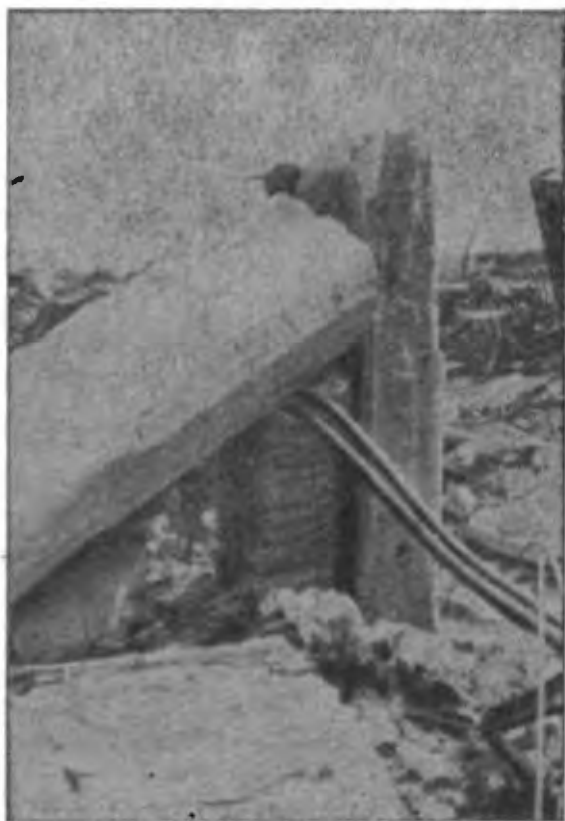
РИС. 3.1. ОБРУШЕНИЕ БЕТОННОЙ КОЛОННЫ
